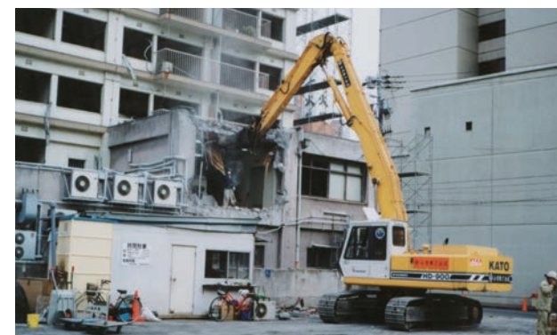
阪神淡路大震災で全壊して取り壊している多聞ビルディング
